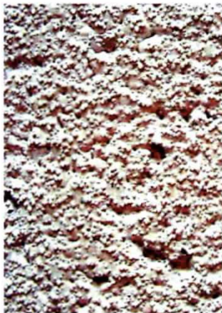
Das Foto zeigt eine herkömmliche Markierung vom Typ I. Bei Regen und hoher Feuchtigkeit ist diese Markierung nachts kaum noch sichtbar, weil die im Markierungsstoff eingebetteten kleinen Reflexperlen schnell vom Wasserfilm überzogen werden. Dadurch wird eine ausreichende Retroreflexion weitestgehend verhindert.
