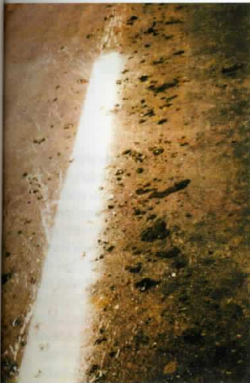
Negativbeispiel: Das Foto zeigt eine absolut nicht fachgerecht aufgebrachte neue Markierung auf einer verschmutzten Fahrhahnoberfläche.
