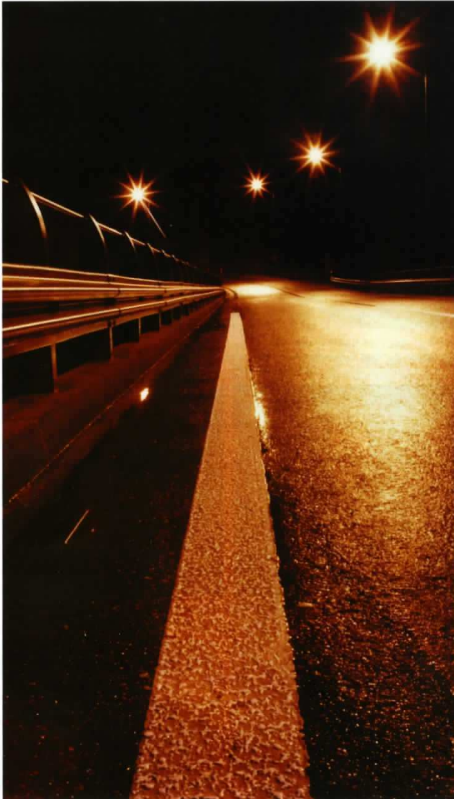
Das Foto zeigt im Vordergrund eine Typ II Markierung (Agglomerat). Sie ist trotz nasser Fahrbahn gut zu sehen. Im hinteren Fotobereich schließt daran eine herkömmliche Typ I Markierung an, die aufgrund der Nässe kaum noch sichtbar ist.
