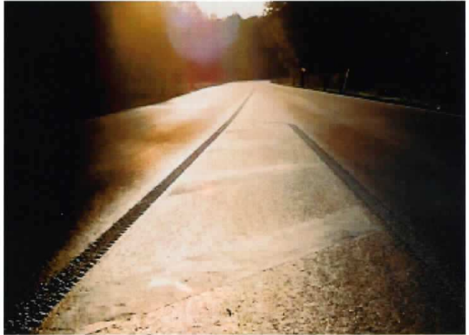
Das Foto zeigt eine Agglomeratmarkierung bei Gegenlicht. Ein Nachteil dieser Markierung ist, dass sie bei flachem Sonnenstand und entsprechendem Gegenlicht am Tag kaum zu sehen ist.
