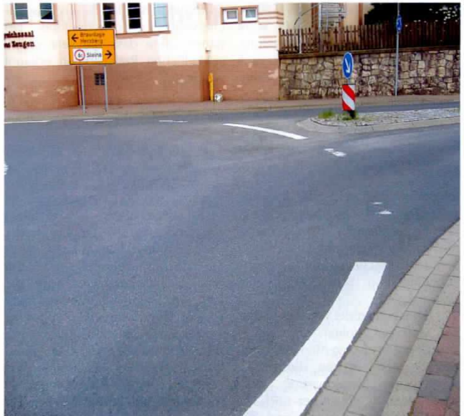
Auf dem o.a. Foto ist zu erkennen, dass die sehr stark beanspruchten Markierungszeichen in der Fahrspur bereits deutlich verschlissen sind, während die weniger befahrenen Zeichen noch vollständig und einwandfrei vorhanden sind. Hier handelt es sich offensichtlich um unvermeidbaren normalen, gebrauchsbedingten Verschleiß.
